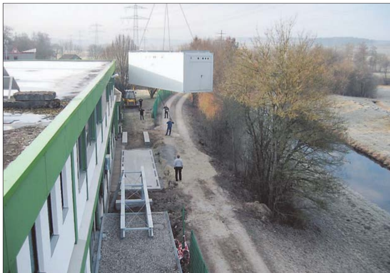
Die neue Wärmerückgewinnungsanlage wurde installiert und die Heizkosten dadurch auf nahezu Null reduziert. Foto: Privat
